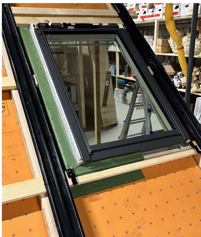
Fenêtre de toit installée sans raccord
