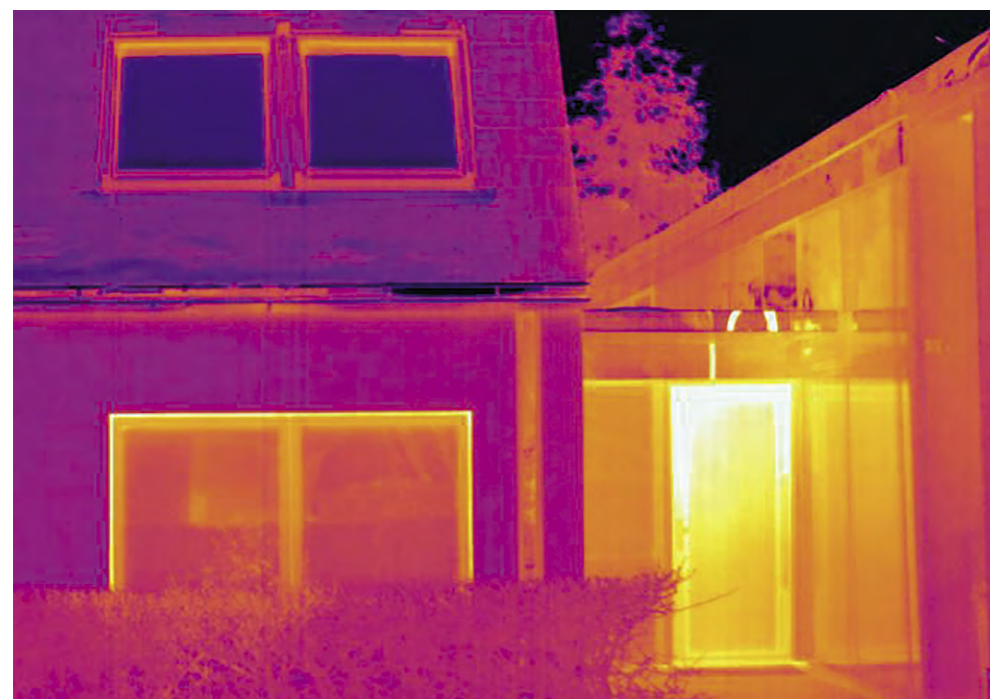
Thermografie von außen zur Visualisierung von Wärmeverlusten
