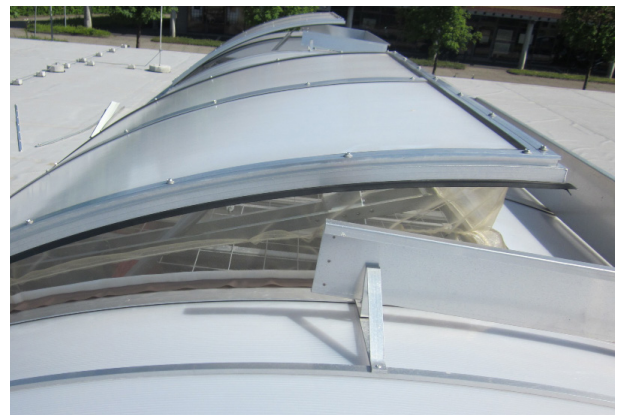
lanterneau avec ouvrant de ventilation et EFC en position ventilation
