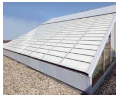
GRILLODUR® lichtstraten met lessenaarsdak
