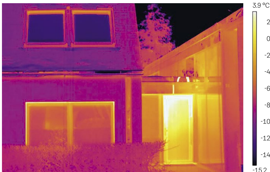
Thermografie von außen zur Visualisierung von Wärmeverlusten
