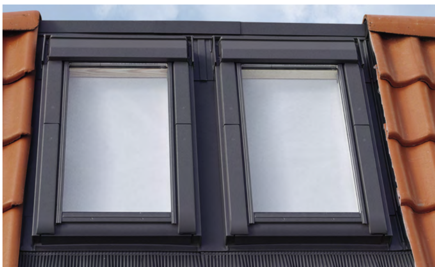
Einbau ohne durchgehenden Firstziegel
