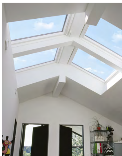
Innenansicht einer Firstlösung
