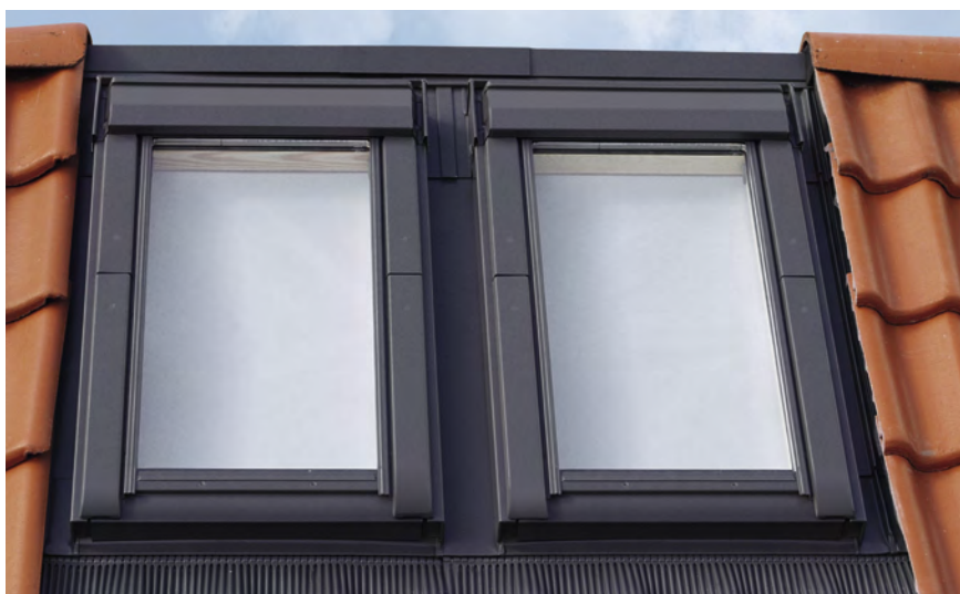
Einbau ohne durchgehenden Firstziegel
