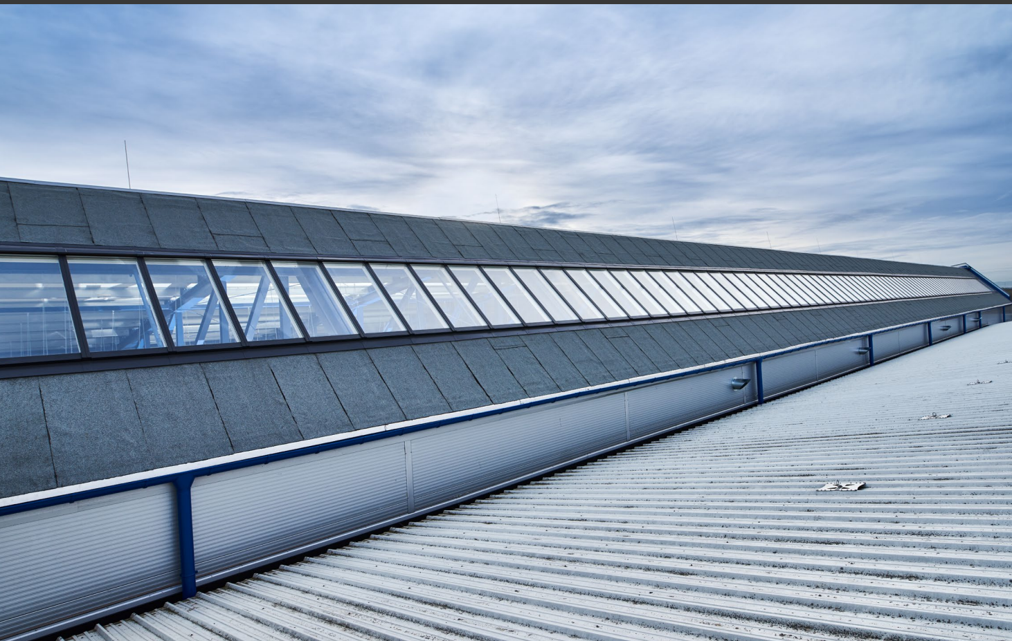
Werkshalle GST, Sierndorf, Österreich. Ein Sheddach, 84 Module.
