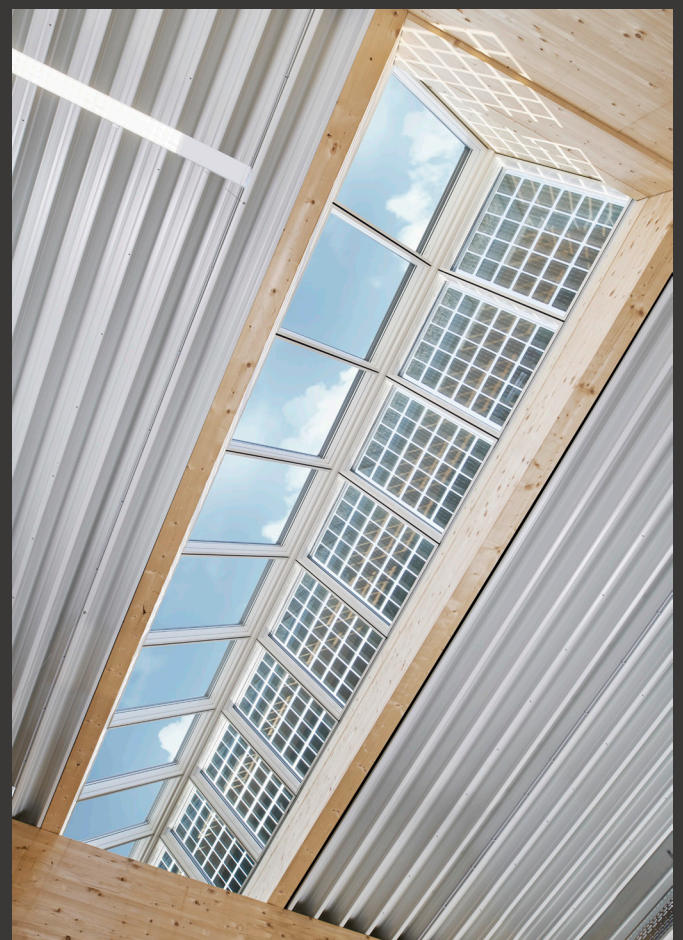
Raiffeisen-Lagerhaus, Kufstein, Österreich. 2 Sattel-Lichtbänder, 92 Module inklusive Photovoltaik-Elementen.
