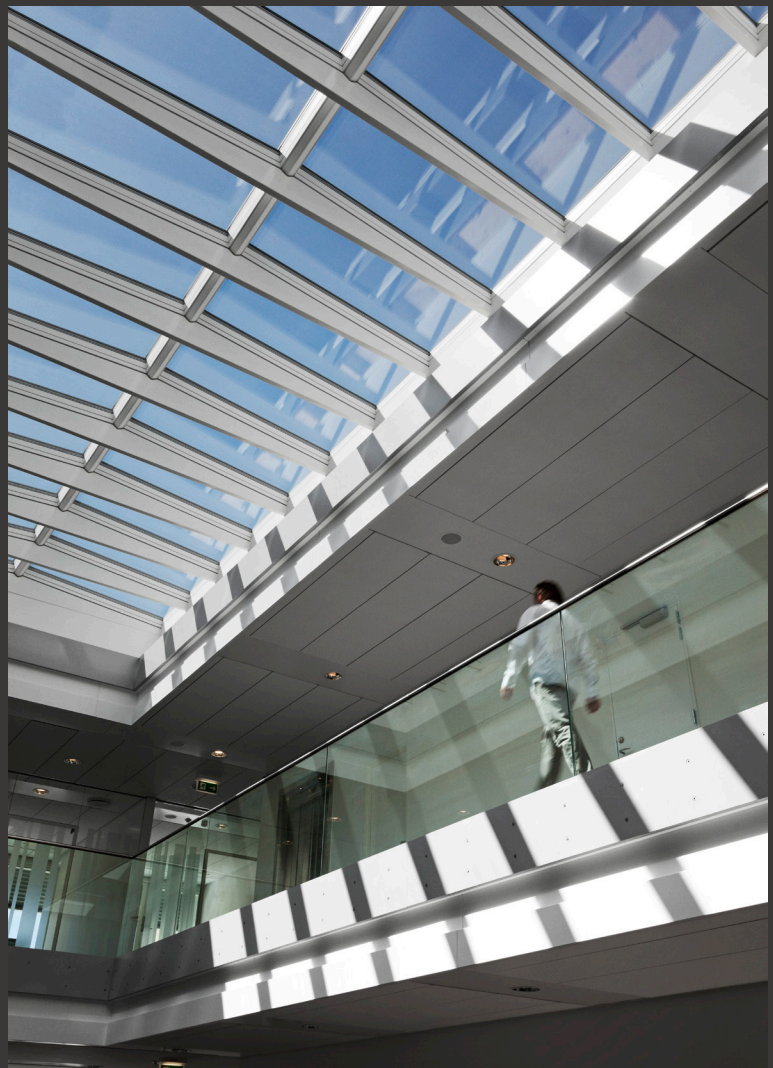
ATP, Vordingborg, Dänemark. Sattel-Lichtband 5° mit Träger, 26 Module.
