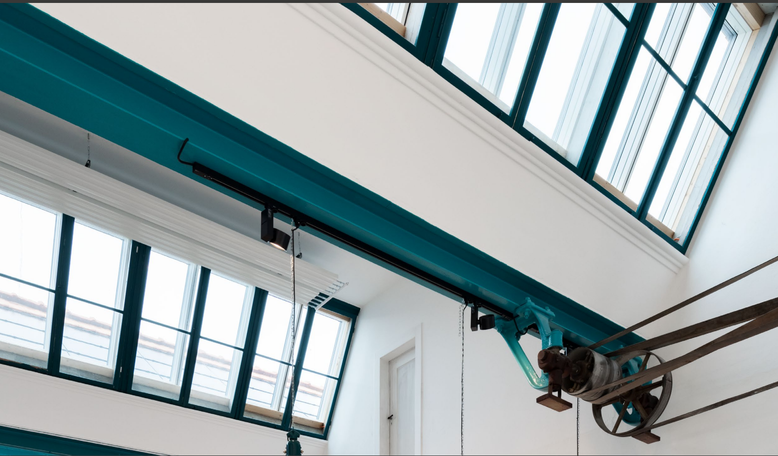
Bucher Areal, Burgdorf, Schweiz. 5 Sheddach-Lichtbänder, 160 Module
