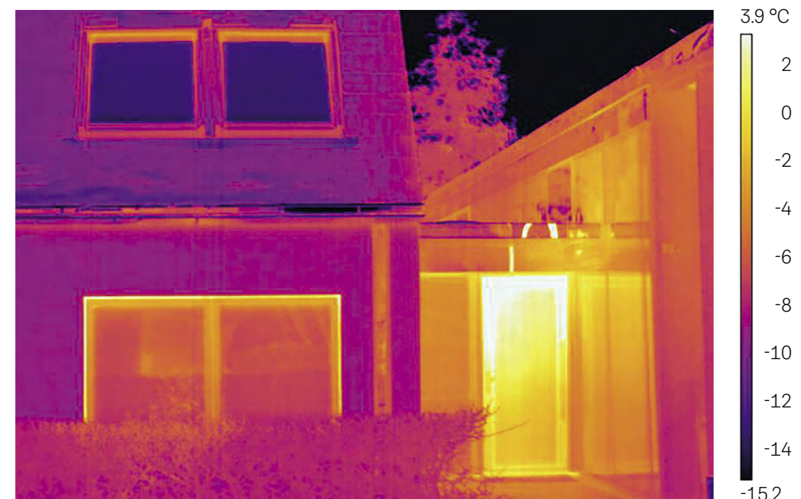
Thermografie von außen zur Visualisierung von Wärmeverlusten
